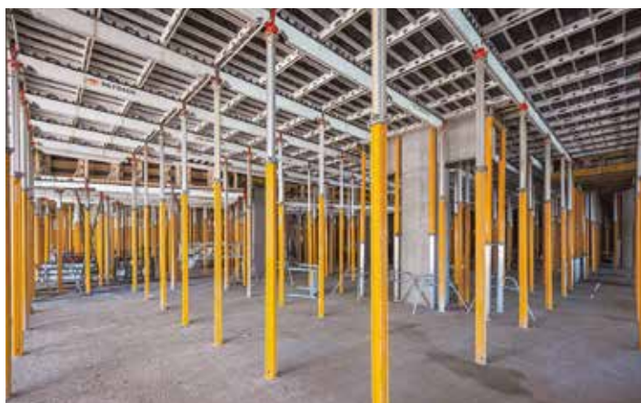
In Spitzenzeiten waren bis zu 7.000 m 2 Deckenschalung, zumeist SKYDECK, und 7.500 MULTIPROP Alu-Deckenstützen im täglichen Einsatz.
