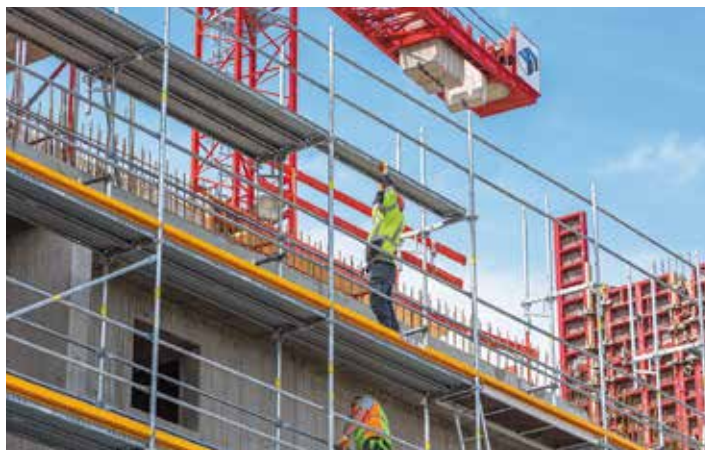
Mithilfe des PERI UP Fassadengerüsts wurden 15.000 m 2 Fassadenfläche baubegleitend eingüstet – dank systemintegrierter Sicherheit ohne Zusatzbauteile.
