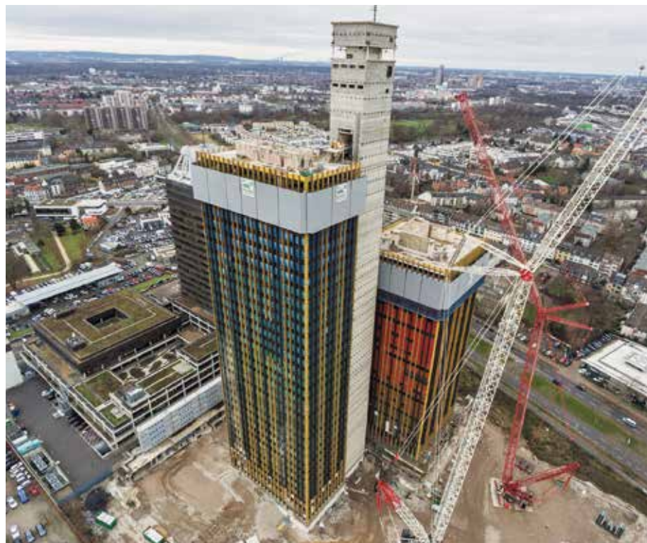
Während das Schutzschild nach unten klettert, werden die Stockwerke Schritt für Schritt abgetragen.
